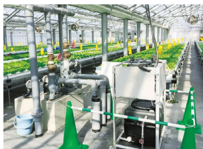
水耕養液供給システム
